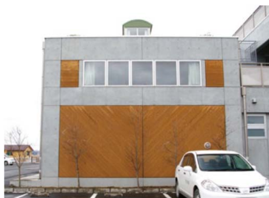
写真7-6 外壁木部の塗料落ち有り
