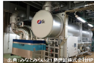
プラント(冷凍機)
