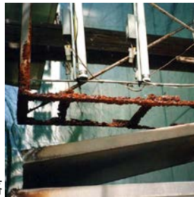
袖看板の底部脱落
