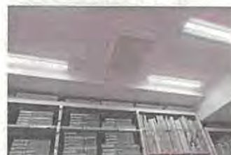
収蔵庫天井部、HEPAフィルターを備えた空調設備
