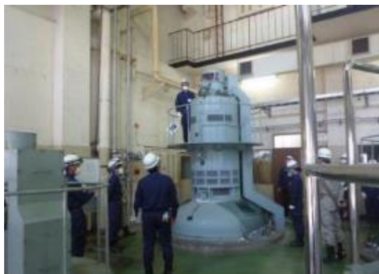
ポンプ設備等の手動運転訓練（令和5年度）
