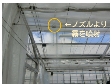
例) 細霧冷房装置
