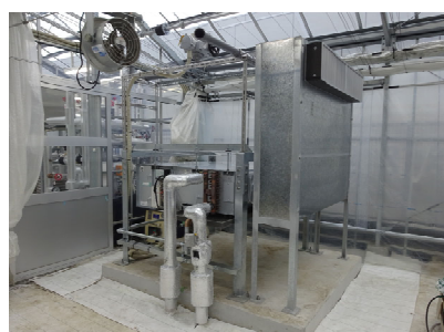
下水熱を活用した空調設備
