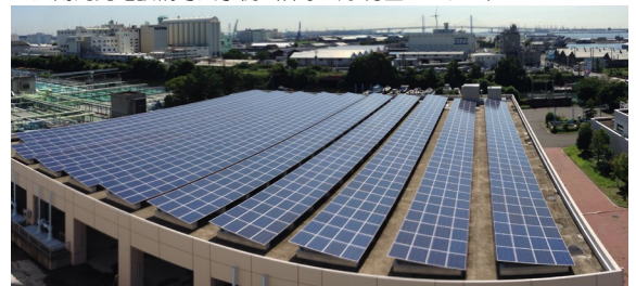
■ 太陽光発電設備導入事例 (神奈川水再生センター)
