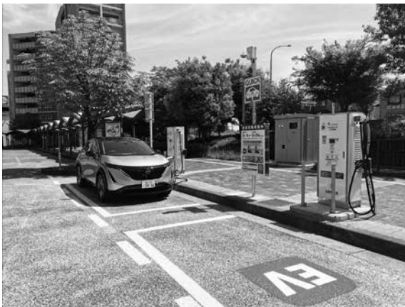
EV 充電器の公道設置に関する実証実験（センター南駅広場）
