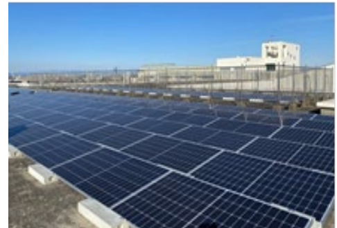
PPA 事業で設置した太陽光パネル （市立中学校）
