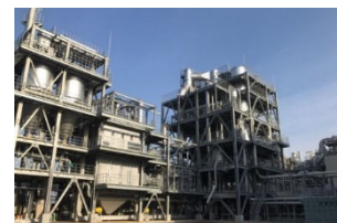
北部汚泥資源化センター 汚泥焼却炉施設(PFI事業)
