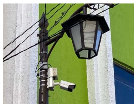
商店街街路灯に設置した防犯カメラ (令和2年度/南区・横浜弘明寺商店街(協))
