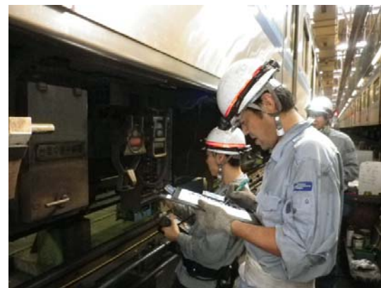
月検査検査作業風景
