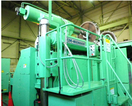
新羽車両基地 車輪転削盤
