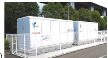
自立型水素燃料電池システム(Y-CC 内)
