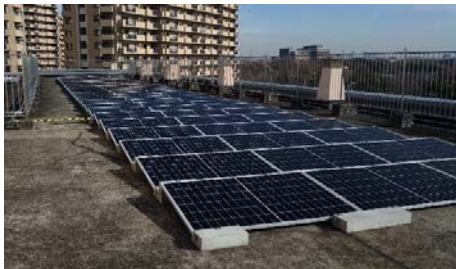
太陽光発電設備
