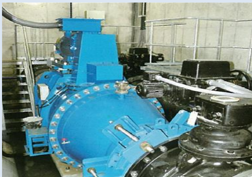
小水力発電（川井浄水場）
