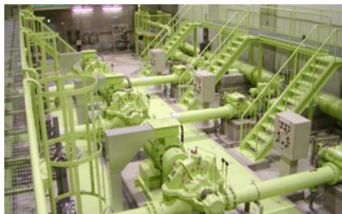
配水ポンプ (V V V F 制御方式)
