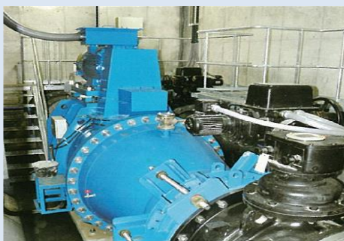
小水力発電（川井浄水場）
