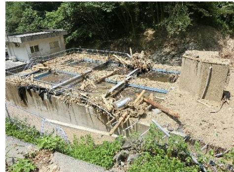
平成 30 年 7 月豪雨による浄水施設の被災状況（愛媛県宇和島市）
