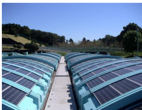
太陽光発電（小雀浄水場）
