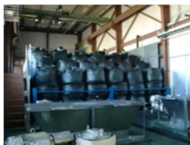
小雀浄水場の既設活性炭設備
