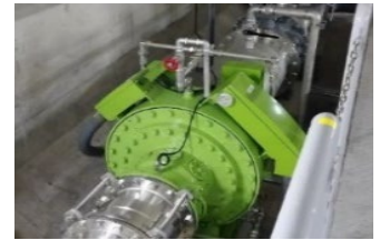
小水力発電設備
