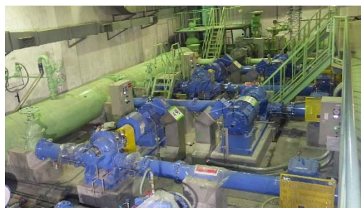
配水ポンプ(VVVF制御方式)
