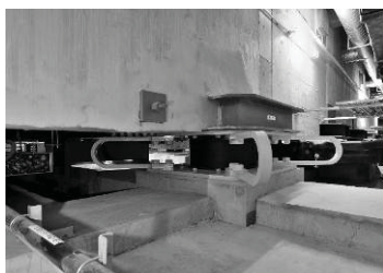
免震・制震装置
