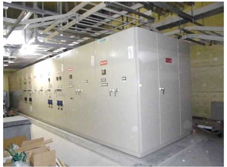
行政棟 電気設備
