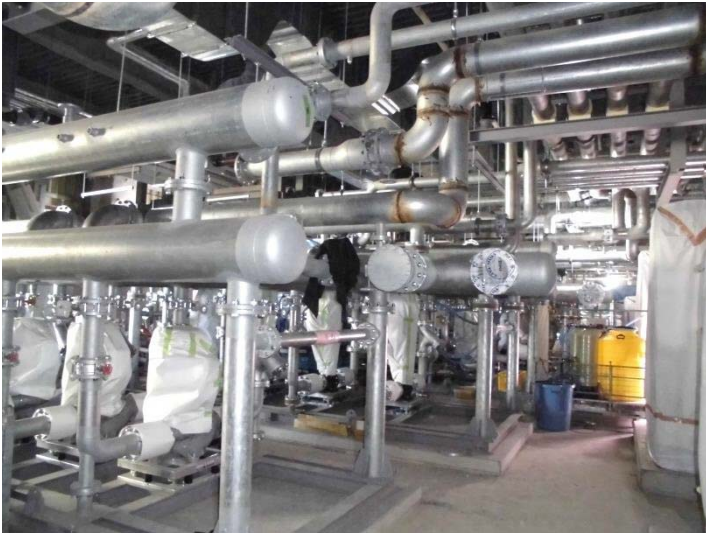
行政棟 機械室設備機器、配管
