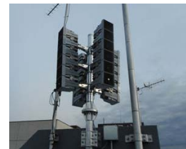
令和元年度に設置した 防災スピーカーの例
