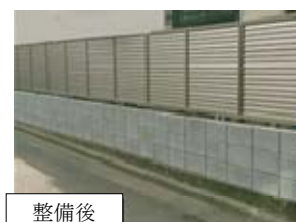
ブロック塀の改善
