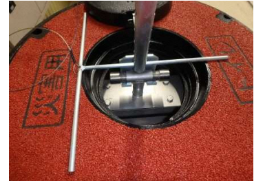
貯留弁の開状態
