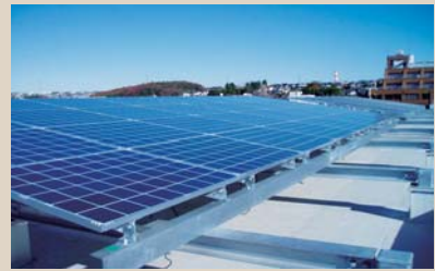
▲川和車両基地の太陽光発電装置
