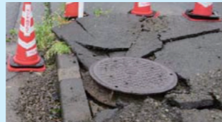
マンホール浮上被害状況
