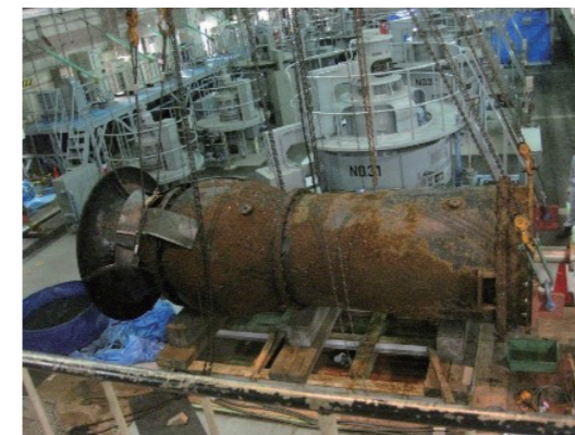
再整備前のポンプ設備
