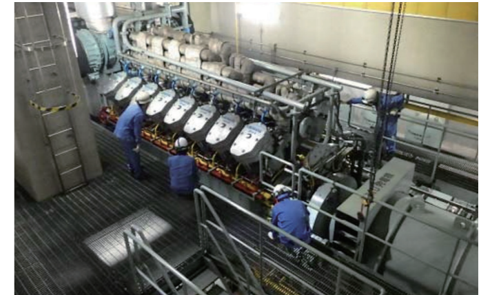
自家発電機設備の点検
