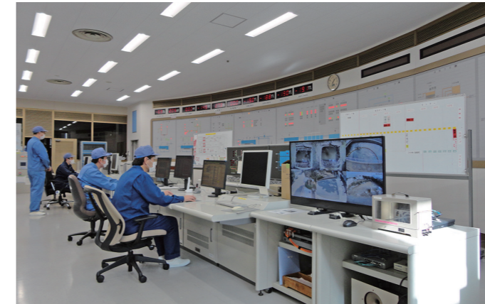
中央操作室での運転管理
