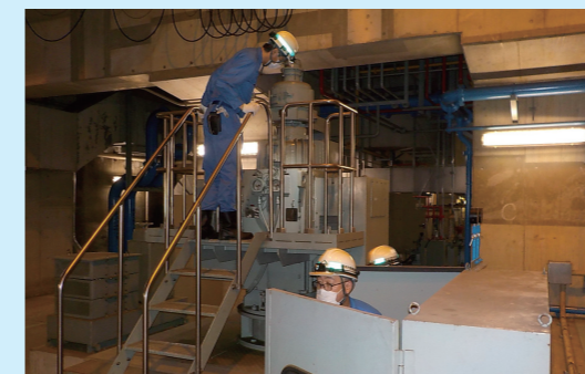
主要設備の点検 ポンプ設備
