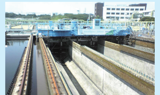
最終沈殿池の採泥機
