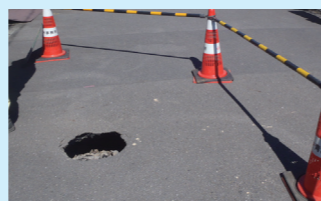
取付管破損による道路陥没
