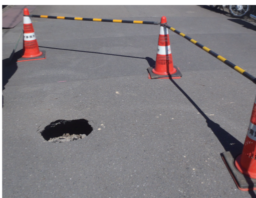
取付管破損による道路陥没
