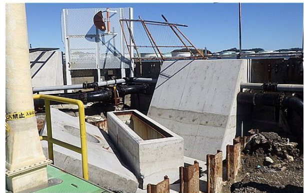
写真—1 放流渠の損傷
