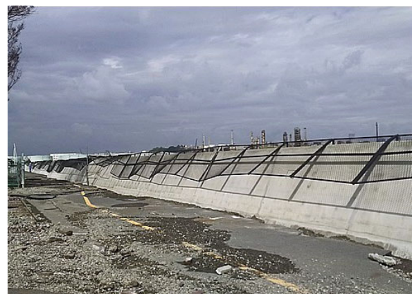
写真—2 護岸フェンスの倒壊
