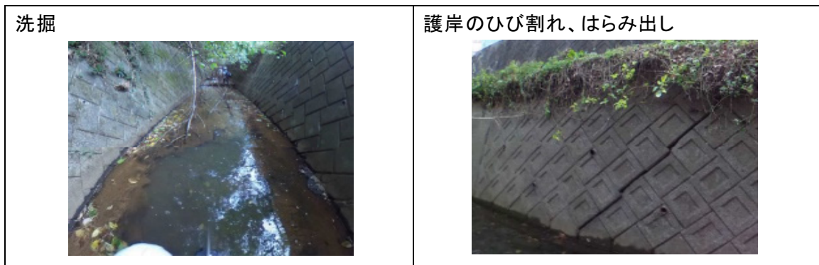
図 2-2 護岸の変状例
