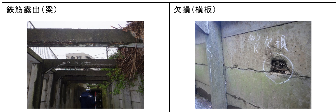
図 2-3 柵きよの変状例
