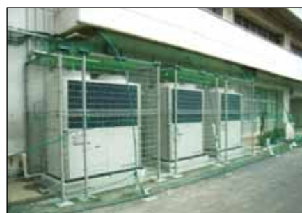
GHPエアコンの室外機
