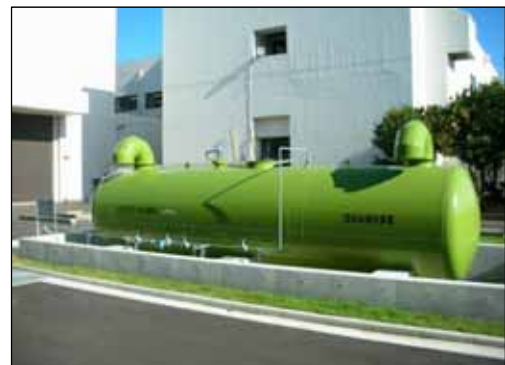
金沢水再生センターのBDFタンク
