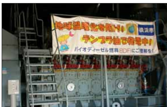
金沢水再生センター（金沢区）の自家発電設備
