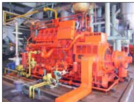
北部汚泥資源化センター（鶴見区）に設置された消化ガス発電設備
