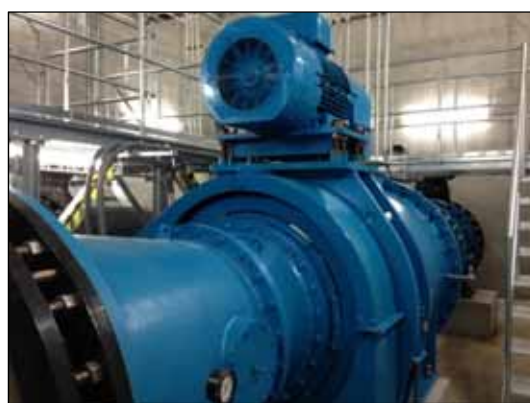
青山水源事務所に設置された小水力発電設備
