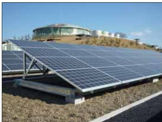
小雀浄水場に設置された太陽光発電設備
