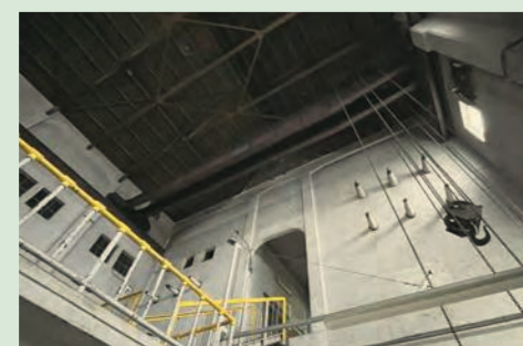
天井には、変電機器運搬用の10トンクレーンを保存
