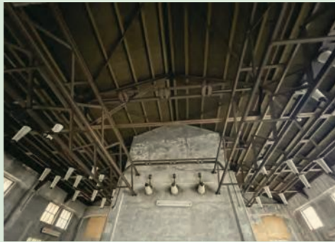
変電所らしく、今も碍子や配線用のアングルも保存
