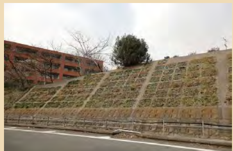
■ 擁壁に植栽ブロックを用いることで圧迫感や威圧感を軽減しています（保土ヶ谷区岡沢町）
