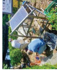
4 太陽光発電設備
