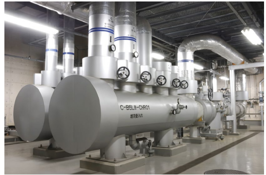
熱供給設備（プラント）
