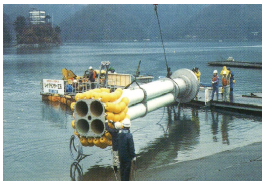
エアレーション装置
