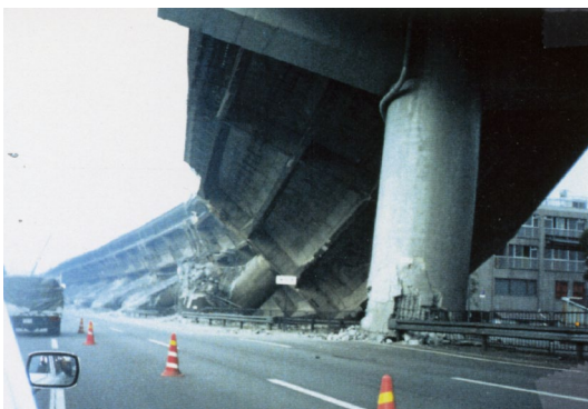
倒壊した阪神高速3号神戸線
