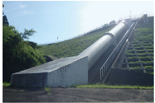
南部幹線斜面管
