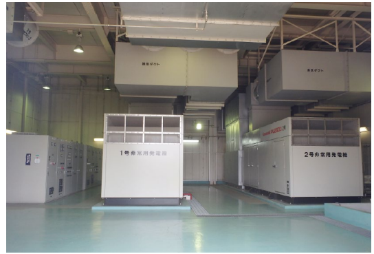
小雀浄水場非常用自家発電設備
