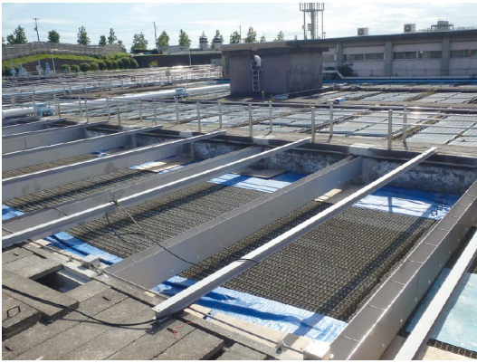
小雀浄水場沈殿池傾斜管
