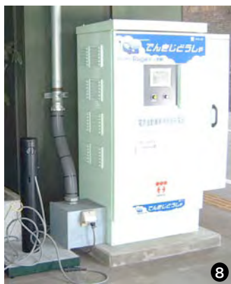
● 電気自動車充電施設
