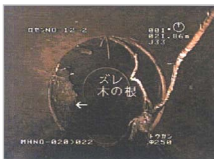
木の根の侵入
