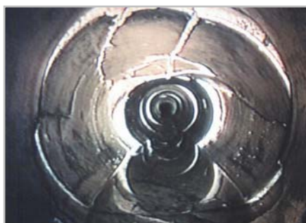
破損・クラック
