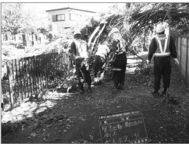
倒木により封鎖された道路の啓開
