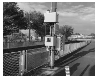
親水拠点警報装置(瀬谷区:相沢川童橋)
