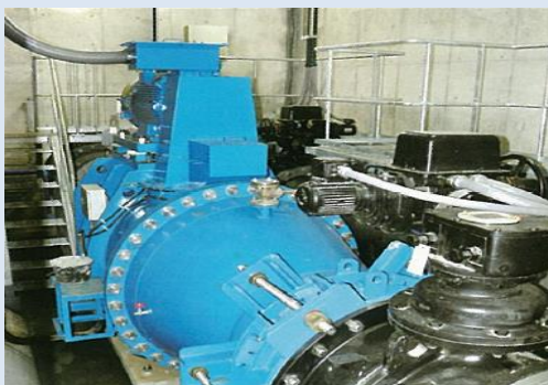
小水力発電（川井浄水場）
