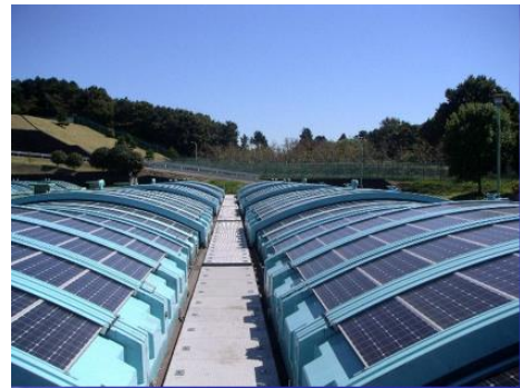
太陽光発電（小雀浄水場）
