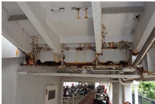
錆びの進行（1986年完成 市営駐輪場内）
