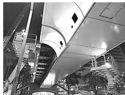
化粧パネルの撤去：みなと大通り1号歩道橋（西区） 令和2年7月完成
