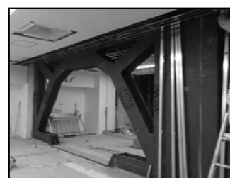
耐震改修事例（ブレース設置工事） ㈱ケー・アール建築研究所 提供
