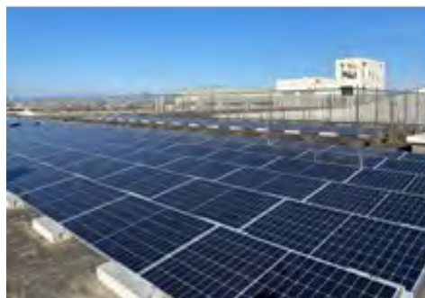
PPA 事業で設置した太陽光パネル （市立中学校）
