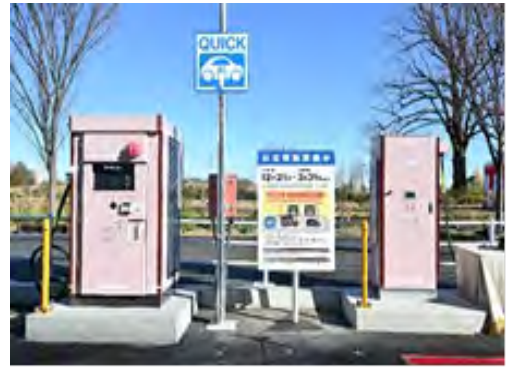
公道充電ステーション (みなとみらい21地区 新港中央広場)
