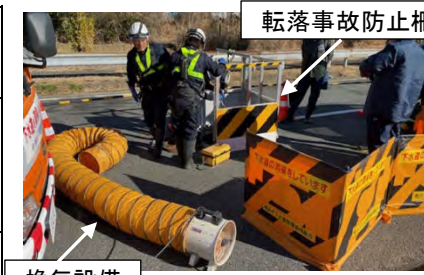
換気設備 転落事故防止柵
