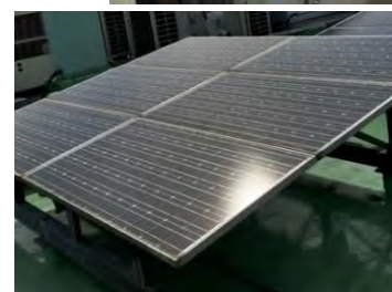
上：コンプレッサー 下：太陽光発電設備
