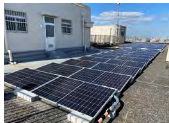
太陽光発電設備
