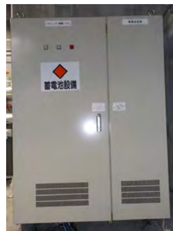
【設置予定の蓄電池】
